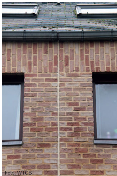
Figure 3.14. Discontinuité du mur de parement
